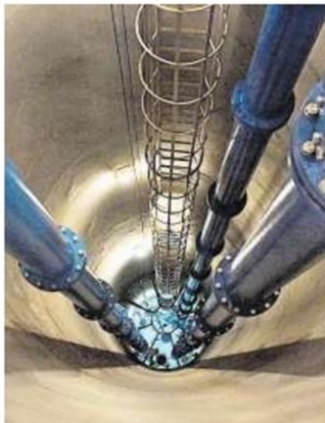
Ein Blick ins Grundwasserpumpwerk Hard II bei Niederlenz, das «Wasser 2035» speisen wird.
